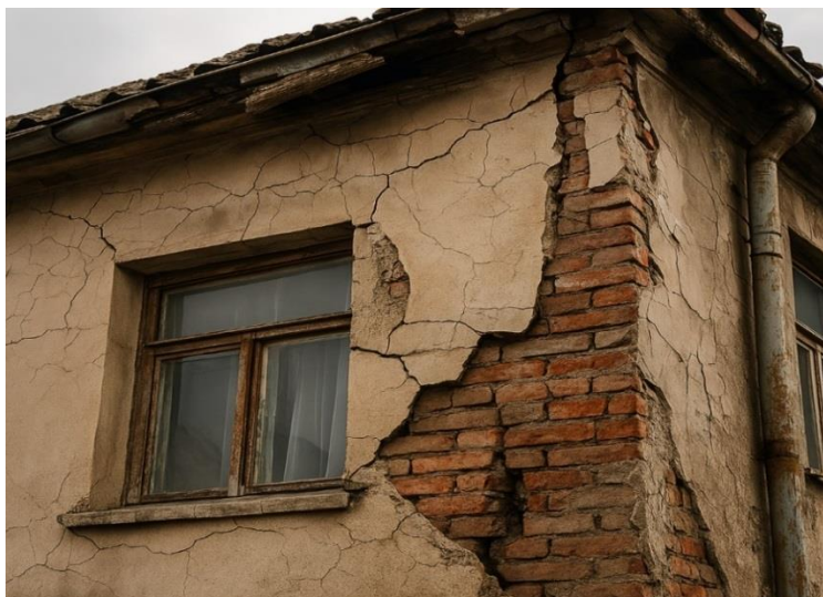
Рис. 2. Износ и повреждения старого здания
