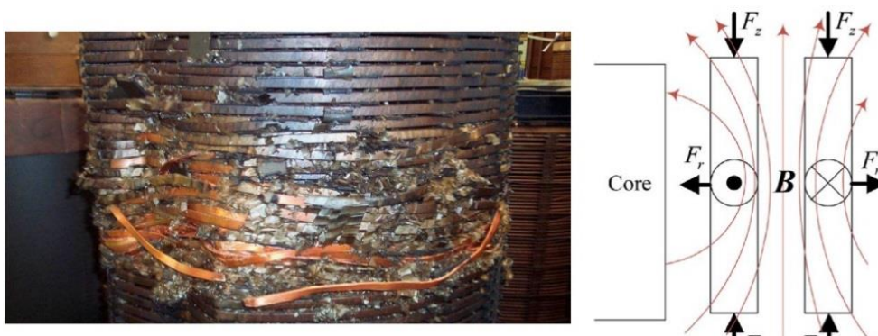
Рис. 1. Силовой трансформатор – пробой межвитковой изоляции
