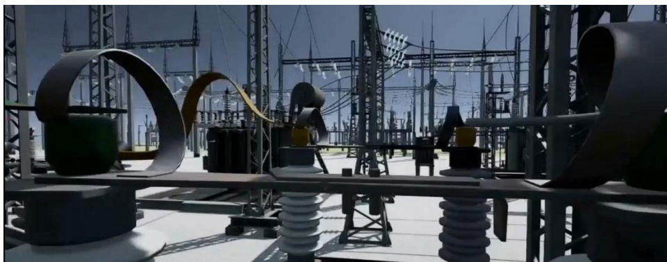
Рис. 2. Вид сбоку на подстанцию 110/10 кВ
