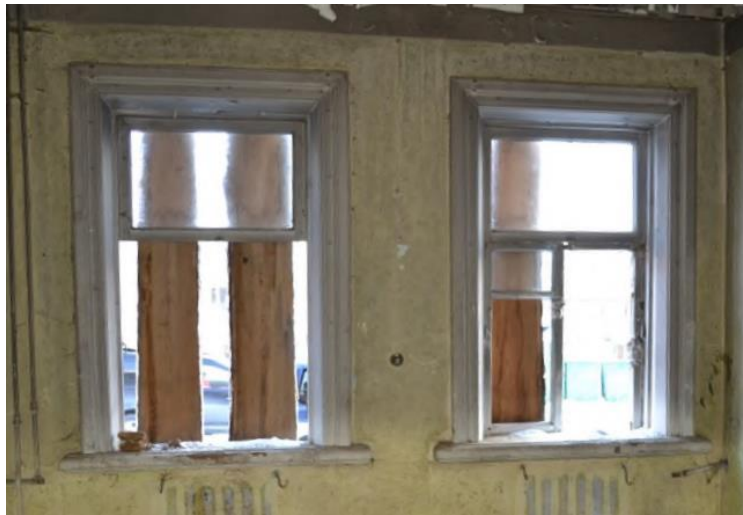
Рис. 1. Состояние окон 1 этажа здания «Дома служащих»
