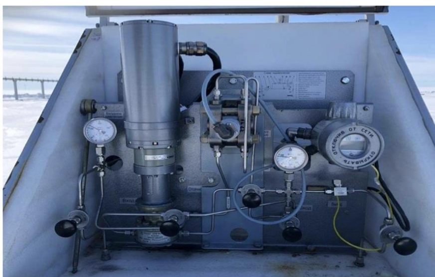
Рис. 3. Система подачи ингибитора
