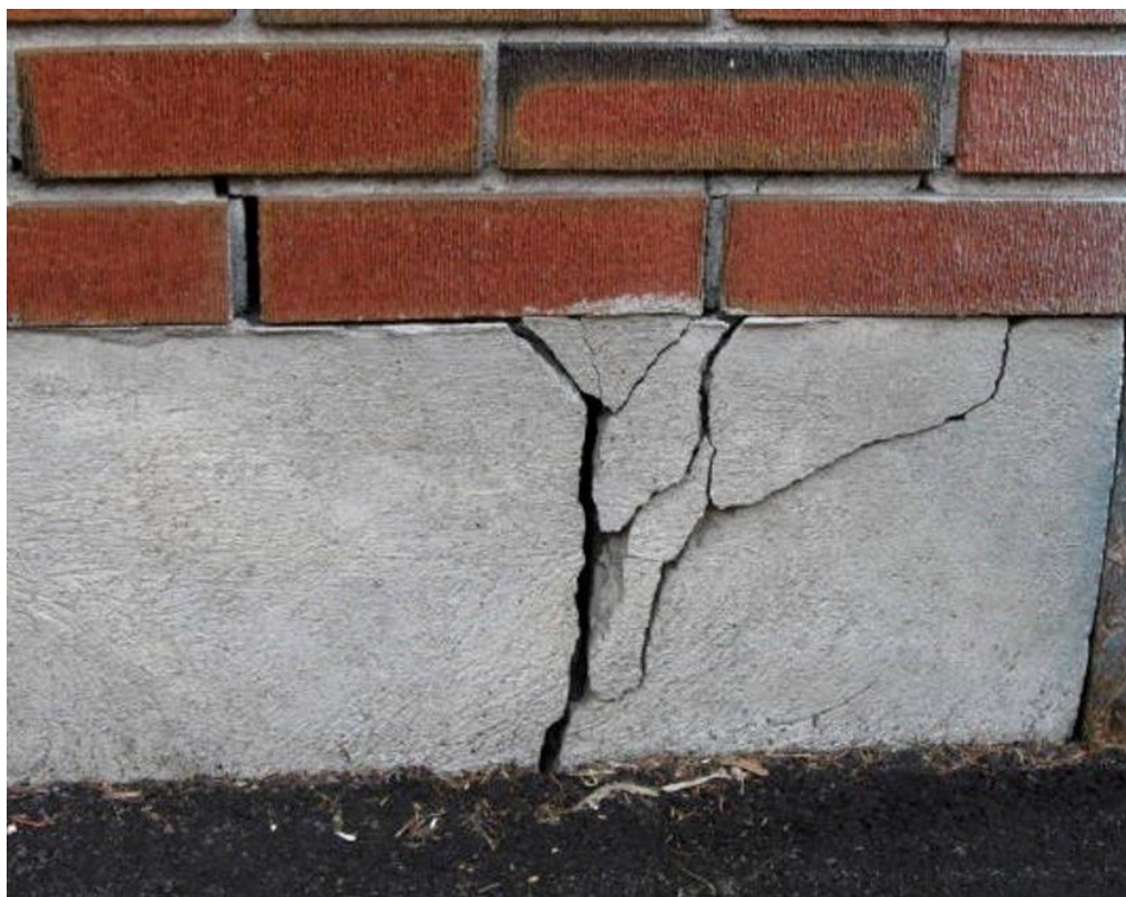
Рис. 2. Трещина в фундаменте
