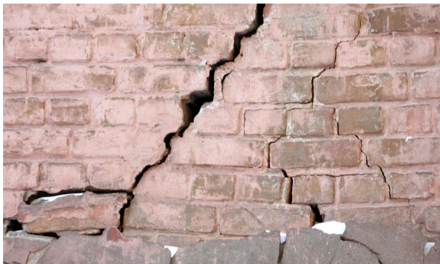
Рис. 3. Трещина в несущей стене здания
