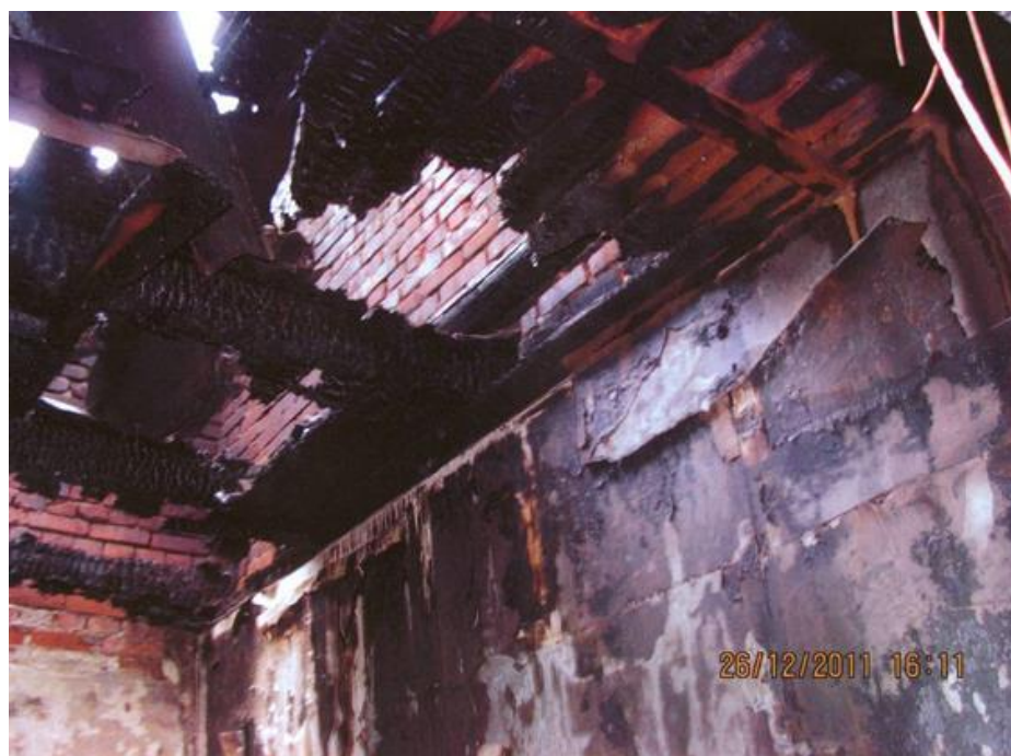
Рис. 2. Последствия пожара в квартире 4-го этажа над эпицентром пожара
