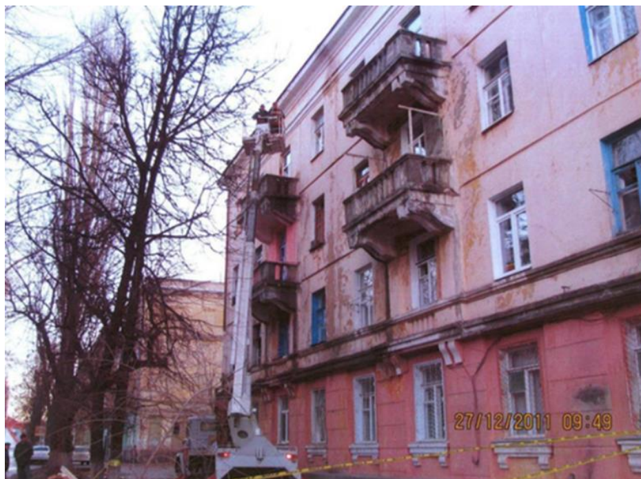
Рис. 3. Последствия тушения пожара на фасаде здания
