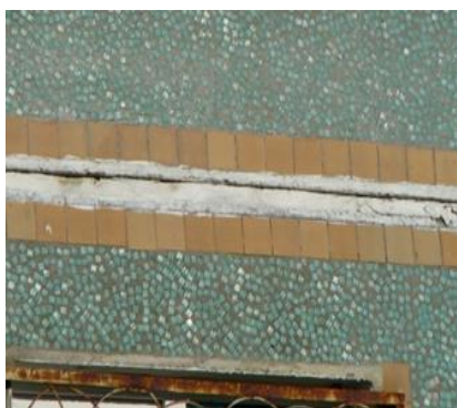
Рис. 1. Трещины в межпанельном шве
