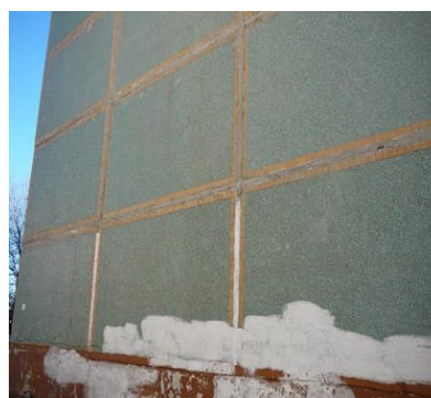
Рис. 2. Промерзание межпанельного шва
