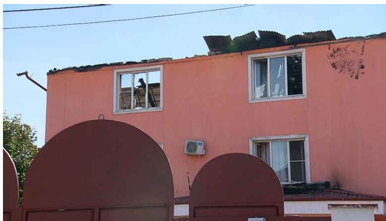
Рис. 1. Пожар в «хостеле», расположенном в Ленинском районе Подмосковья 11.08.2022 г., в результате которого погибло трое детей
