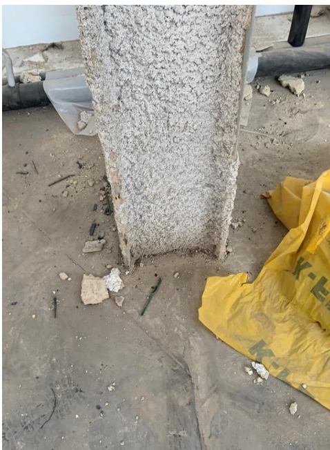
Рис. 2. Деформационные швы у колонны
