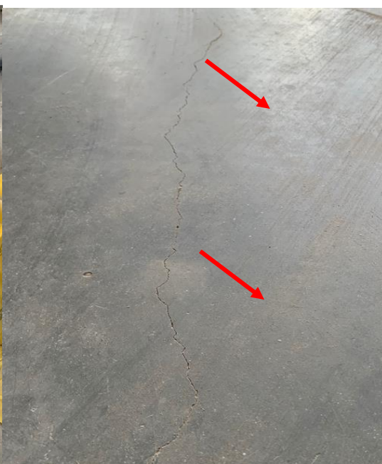
Рис. 3. Трещины в полу
