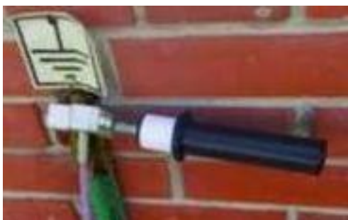
Рис. 2. Струбцина для заземления пожарного насоса
