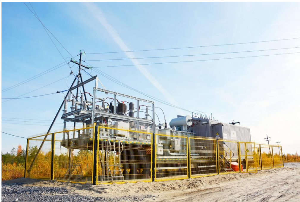
Рис. 1. Мобильная модульная подстанция
