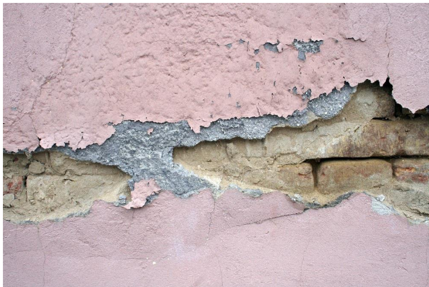
Рис. 2. Пустоты штукатурного фасада
