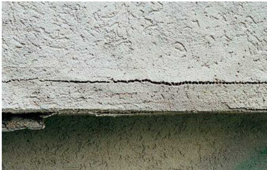
Рис. 1. Трещины штукатурки «мокрого» фасада
