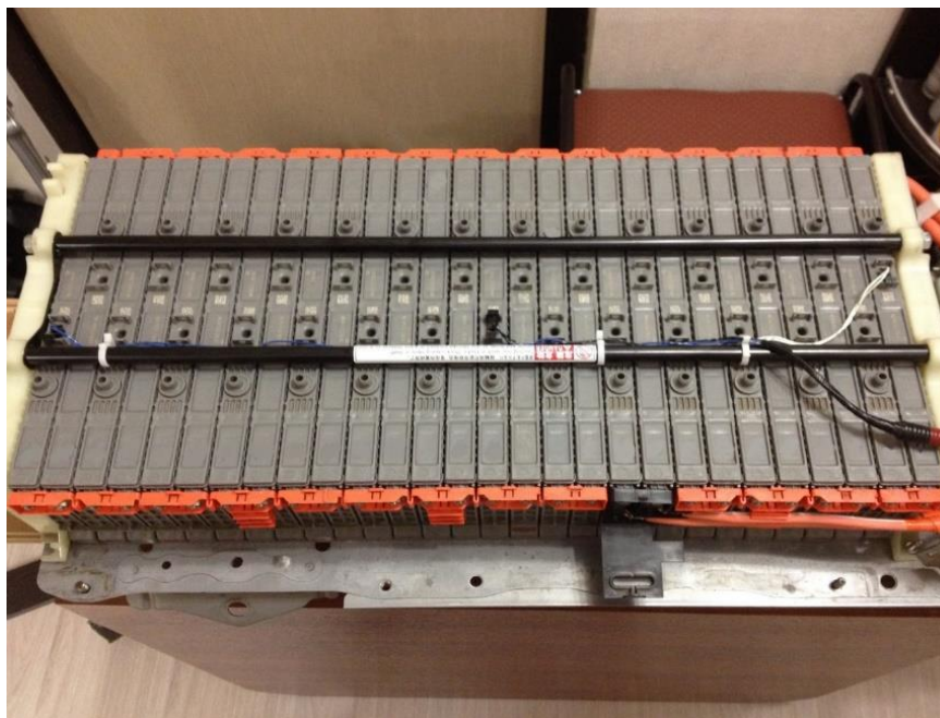
Рис. 1. Общий вид высоковольтной батареи
