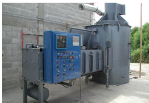
Рис. 6. Установка «Пеннрам» (инсинератор)
