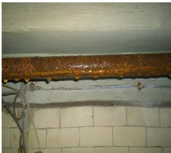
Рис. 4. Фотография трубы в водомерном узле
