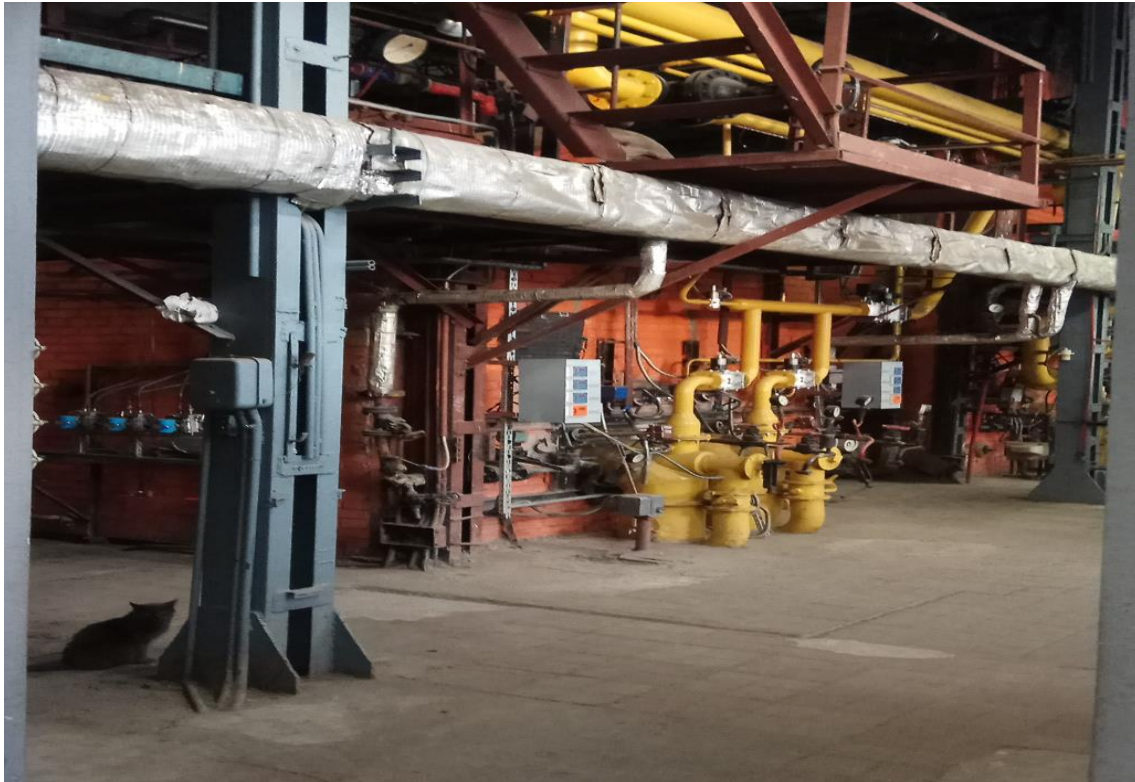
Рис. 1. Котельная установка на базе котла ДКВР-10
