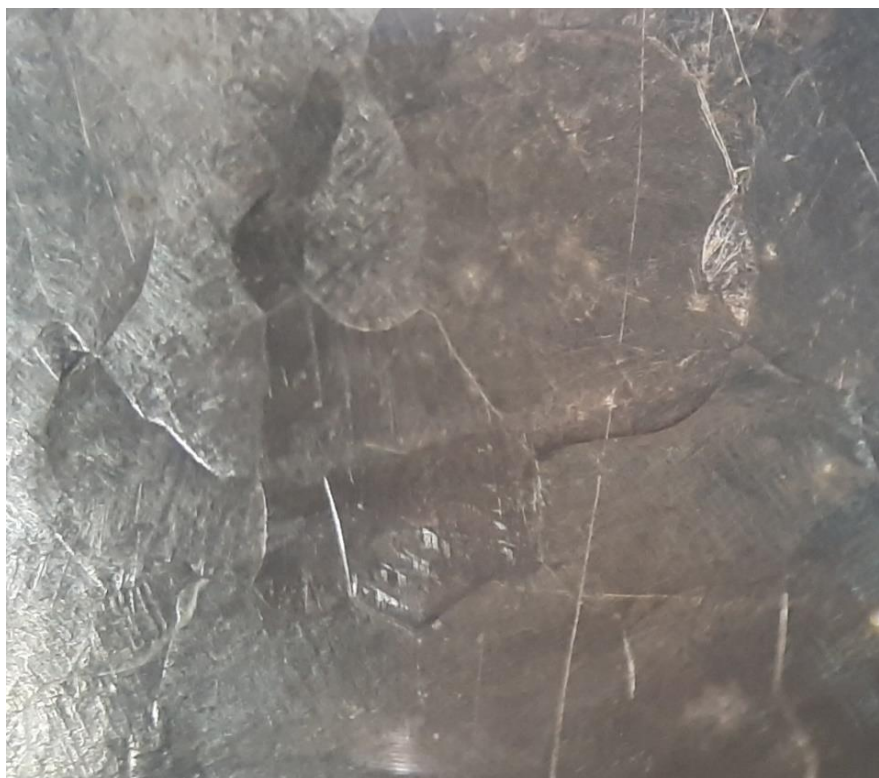
Рис. 4. Поверхность сварного шва
