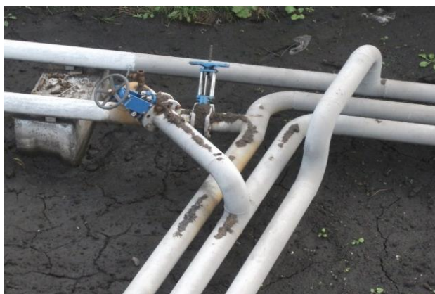
Рис. 1. Трубопроводы противопожарных резервуаров: №2, №3 и №4
