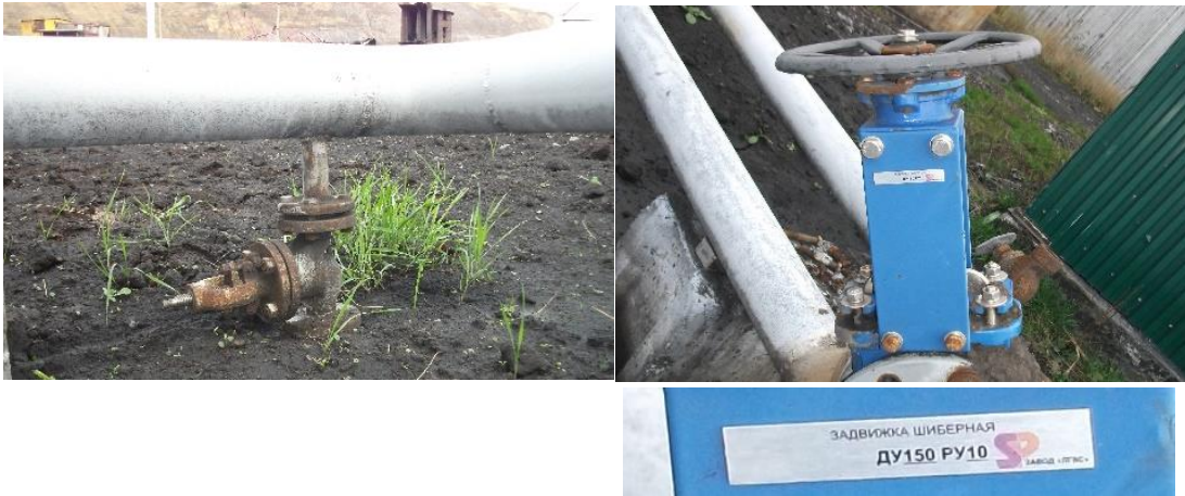
Рис. 4. Задвижка трубопровода, маркировка задвижки
