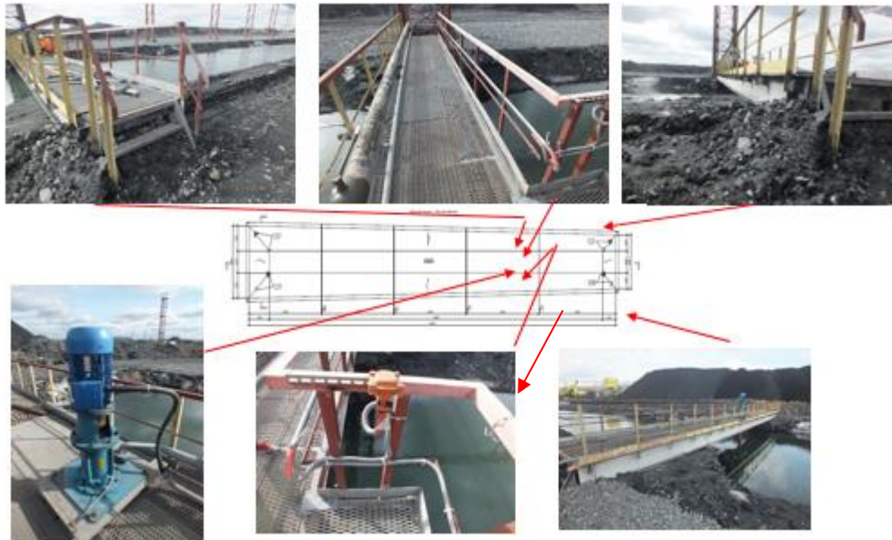
Рис.6.2.1. Общий вид станции перекачки шламовых вод
